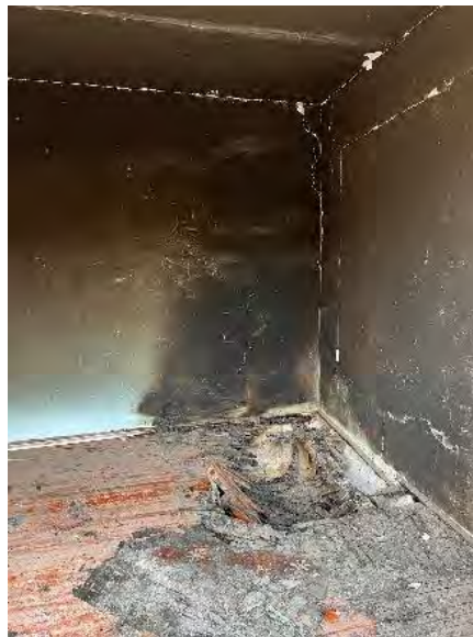
Поврежденное огнем внутреннее помещение одного из домов в селении Ак-Сай. Такие повреждения в результате, предположительно, умышленных поджогов таджикистанскими силами 16 сентября 2022 г. присутствуют во многих домах. Кыргызстан. © 2022 Jean-Baptiste Gallopin/Human Rights Watch
